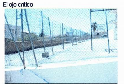
Vallas en mal estado en CP Reina Sofia Una madre indignada nos envía esta foto para denunciar que las rejas de este colegio de s'Horta nunca se arreglan Publica tu fotodenuncia | Ver más | Galeria antigua
