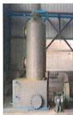
Sistema de filtración de gases no deseables.(13)
